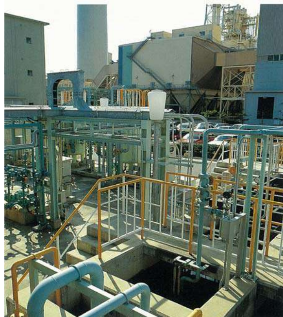
石川石炭火力発電所(回収水処理装置)
