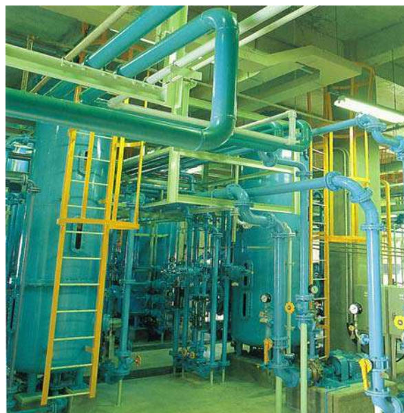
石川石炭火力発電所(純水製造装置)
